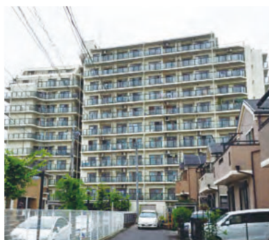
施工部位 ルーフバルコニー他 工法名 NK(UN工法) 施工員会社 株式会社 株式会社 現場施工責任者 七戸和人氏
